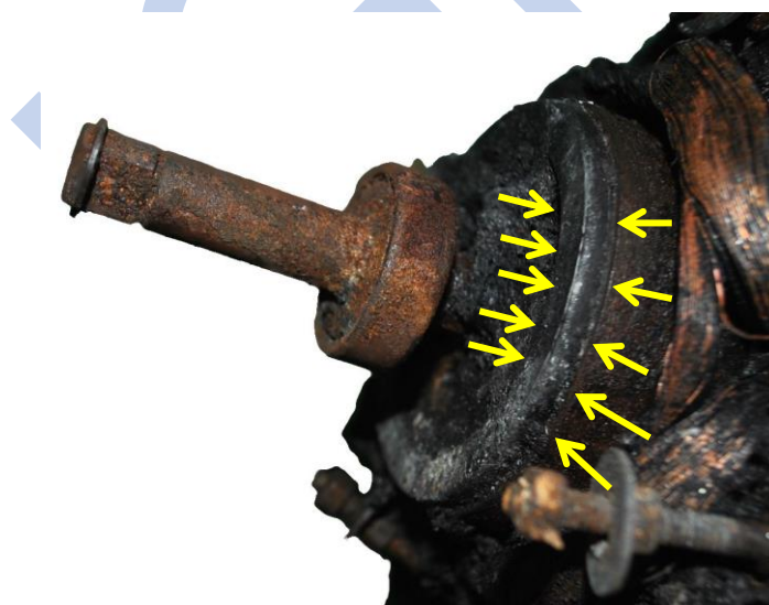
Foto 7 -Outro ventilador colhido nos escombros do incêndio. Apesar de todas as peças plásticas terem sido consumidas pelas chamas, os anéis da "gaiola de esquilo" permaneceram intactas.
