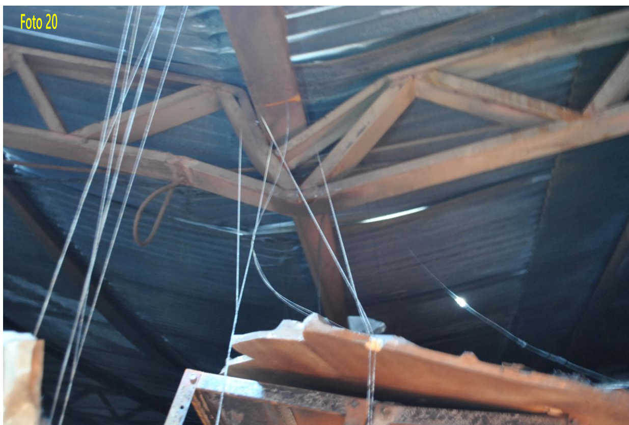
Ponto onde ruiu a cobertura no SETOR 2, alinhado ao depósito de álcool.
