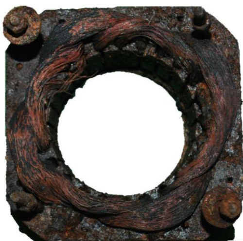
Foto 4 - Motor do ventilador
